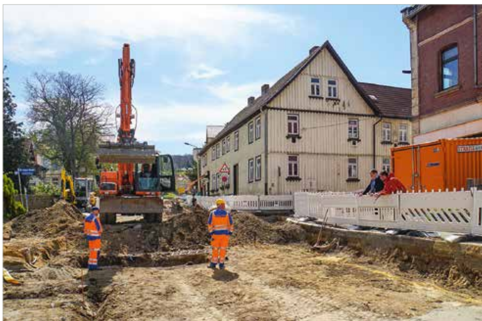
Bauleiter Robin Struwe (rote Jacke) informiert Bürgermeister Heiko Breithaupt über den zweiten Bauabschnitt in der Herzogstrasse.
