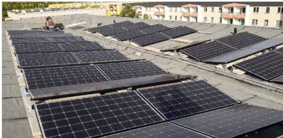
Photovoltaik-Anlage auf einem Mehrfamilienhaus im Wohngebiet Regenstein.
