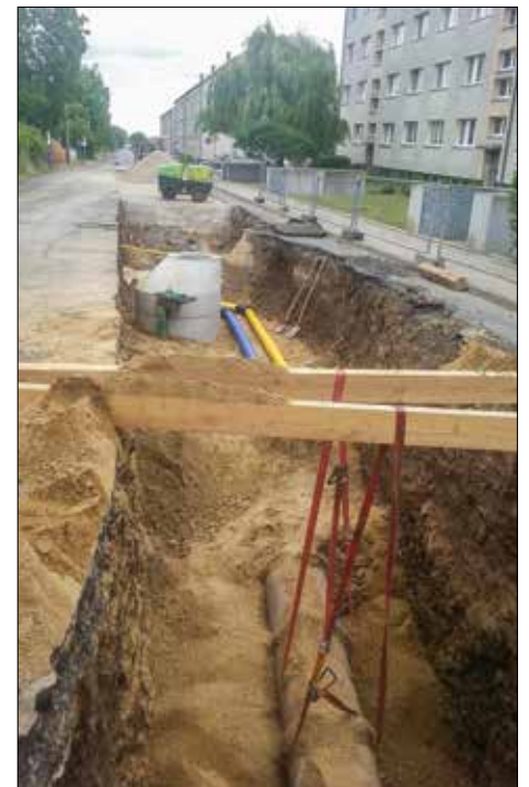
Unter der alten brüchigen Abwasserleitung musste die neue verlegt werden. Ein riskantes Vorhaben, das den Tiefbau fachleuten aber bestens gelang. Foto: TAZV
